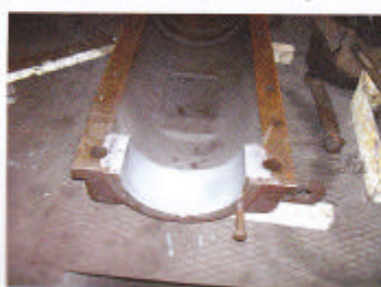
Рис. 7. Восстановленная опорная поверхность в крышке.
