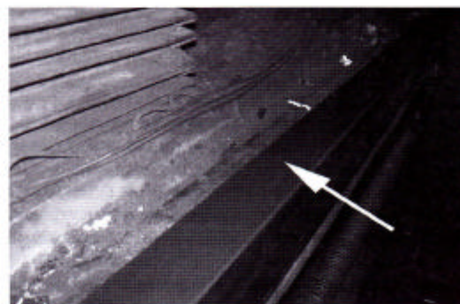
Рис. 8. Восстановленная поверхность направляющей. Стрелка указывает на восстановленную поверхность
